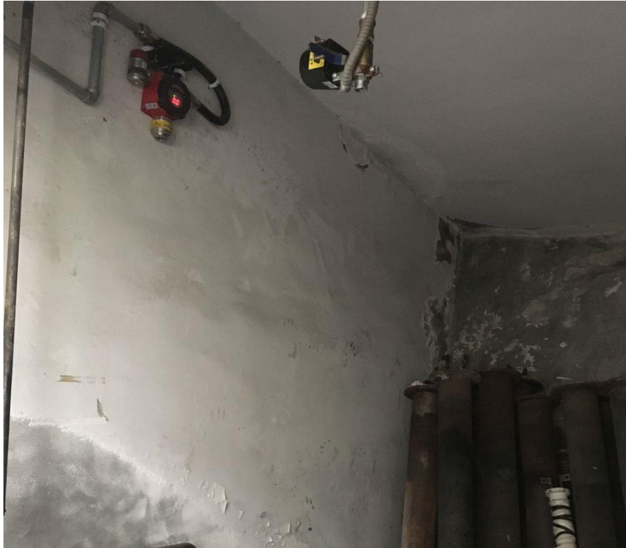
图 8 液氨毒性气体警示仪和喷淋设备
